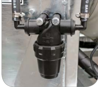
Filtri di controllo prima dei cannoni
